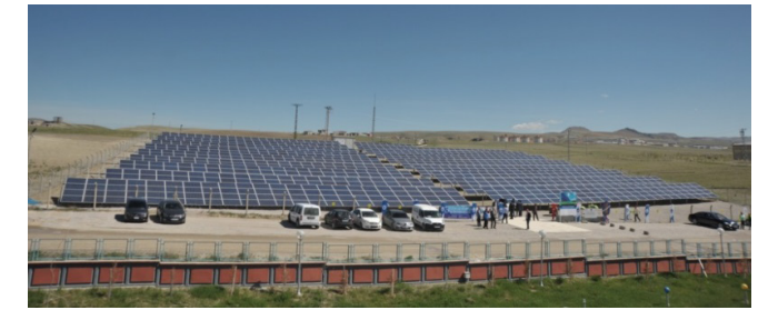
Fotoğraf 23 : 2012 YEK MDP Kapsamında Desteklenen Bir Güneş Enerjisi Projesi
