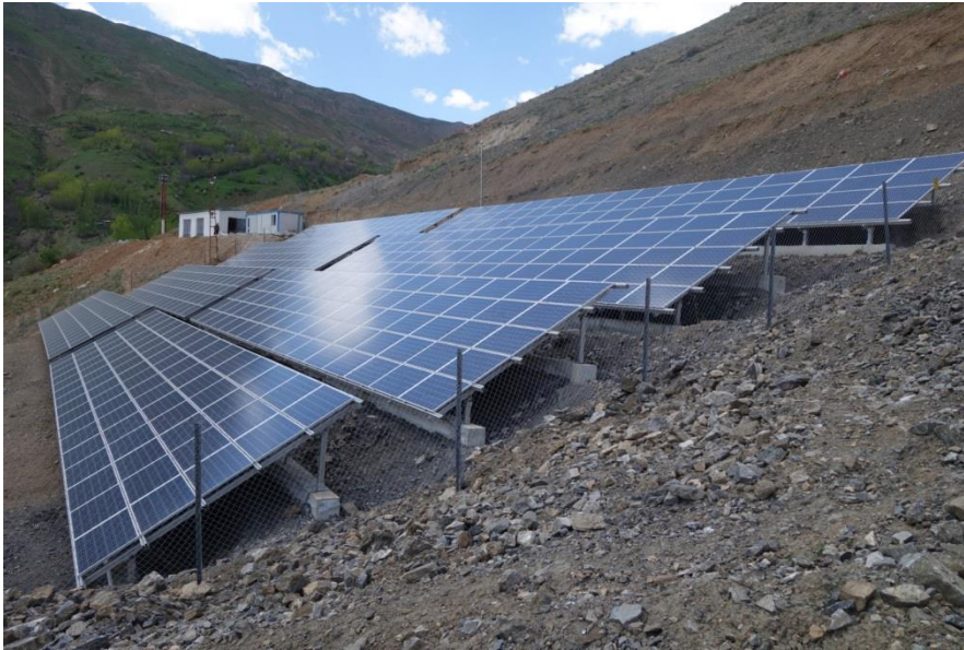
Fotoğraf 5: 2012 YEK MDP Kapsamında Desteklenen Bir Güneş Enerjisi Projesi
